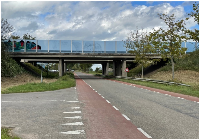
Ruimte voor een dubbel fietspad links tussen de pijlers en het talud.
